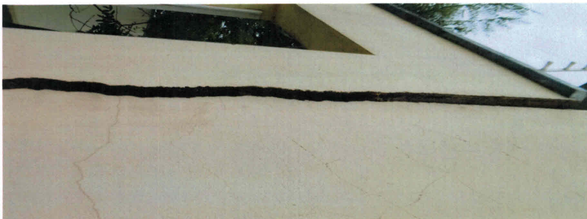
TRINCO NA PAREDE
