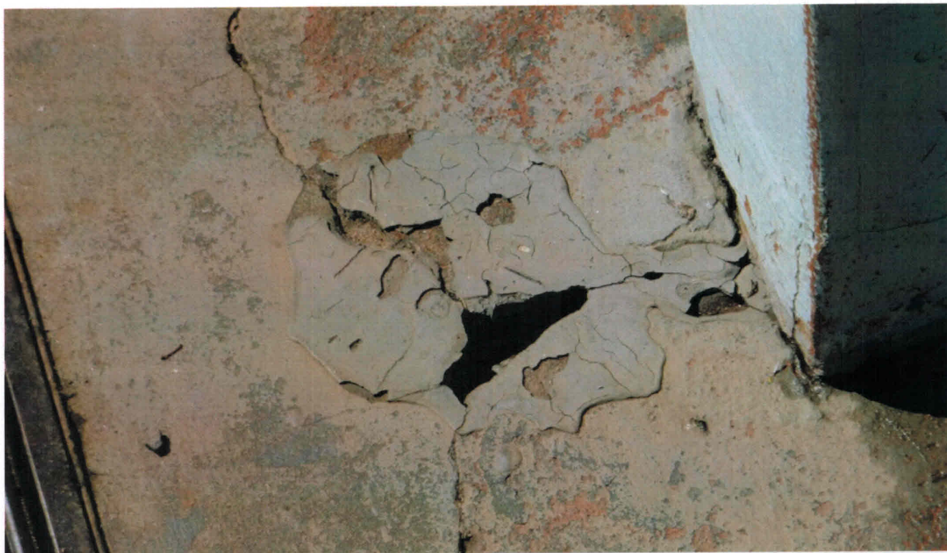
BURACO NO PÁTIO ENTRE PISO E COLUNA DE CONCRETO
