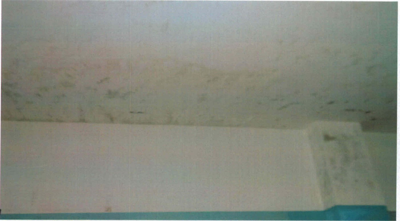
INFILTRAÇÃO SALA DE AULA
