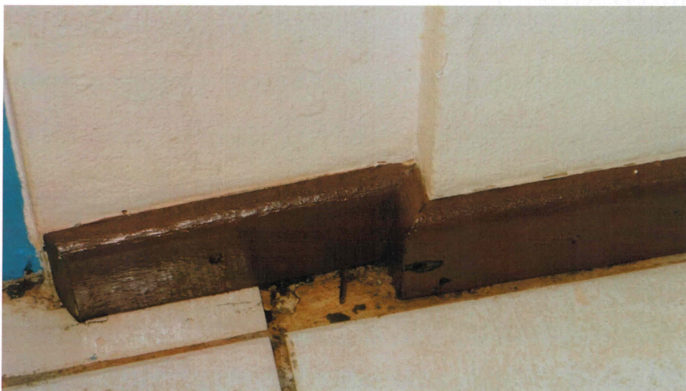
FALTA PARTE DO AZULEJO
