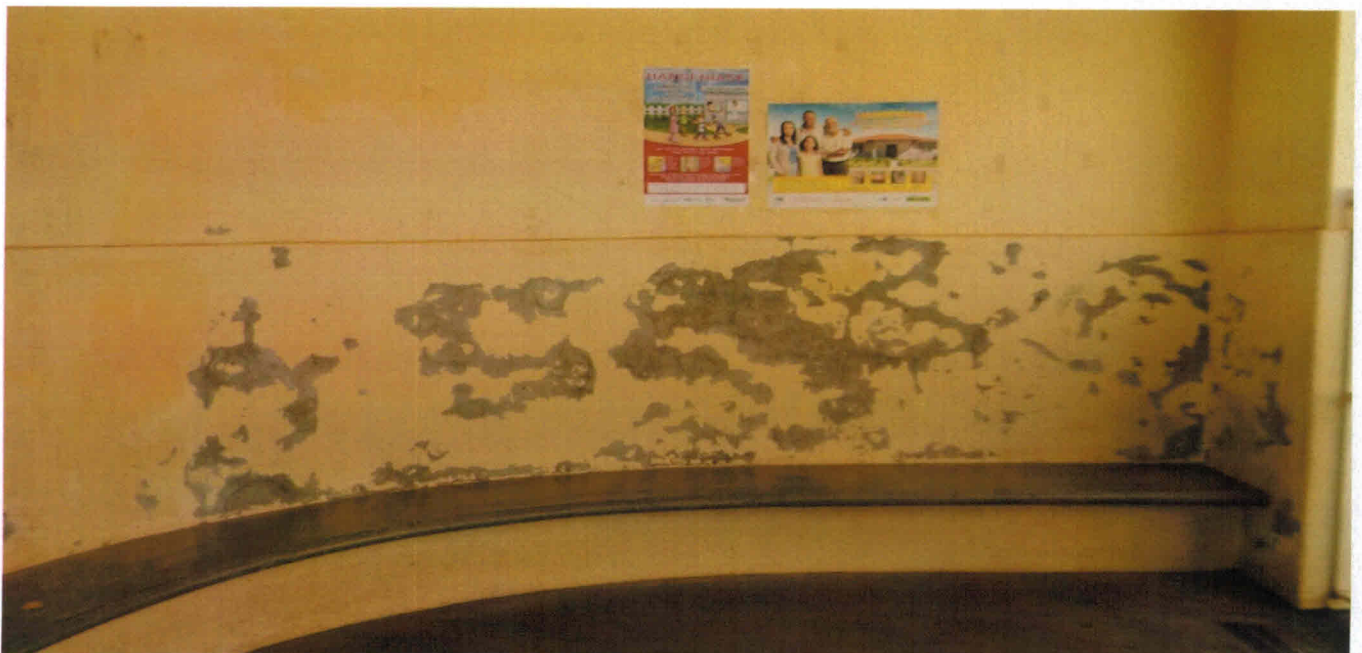
DANOS NA PINTURA
