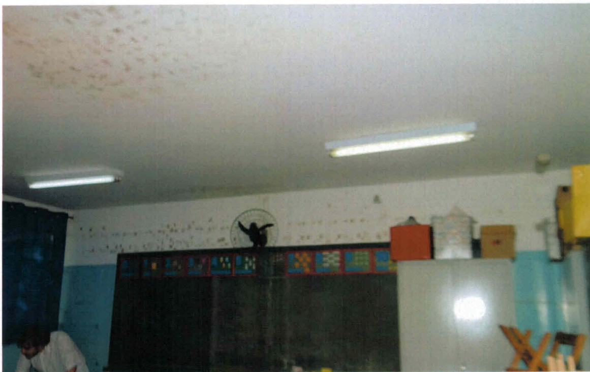
INFILTRAÇÃO SALA DE AULA
