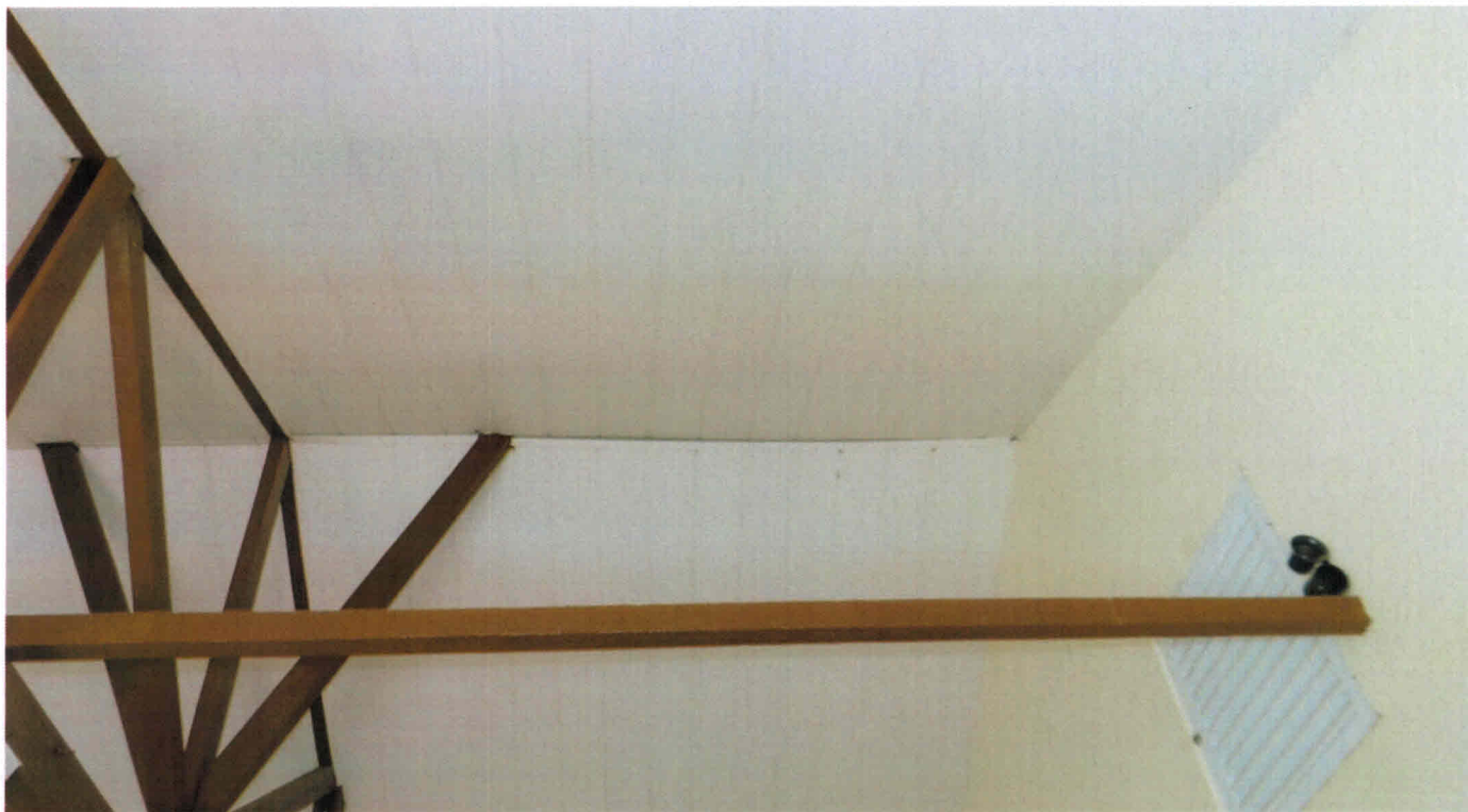
FORRO DE PVC CEDENDO
