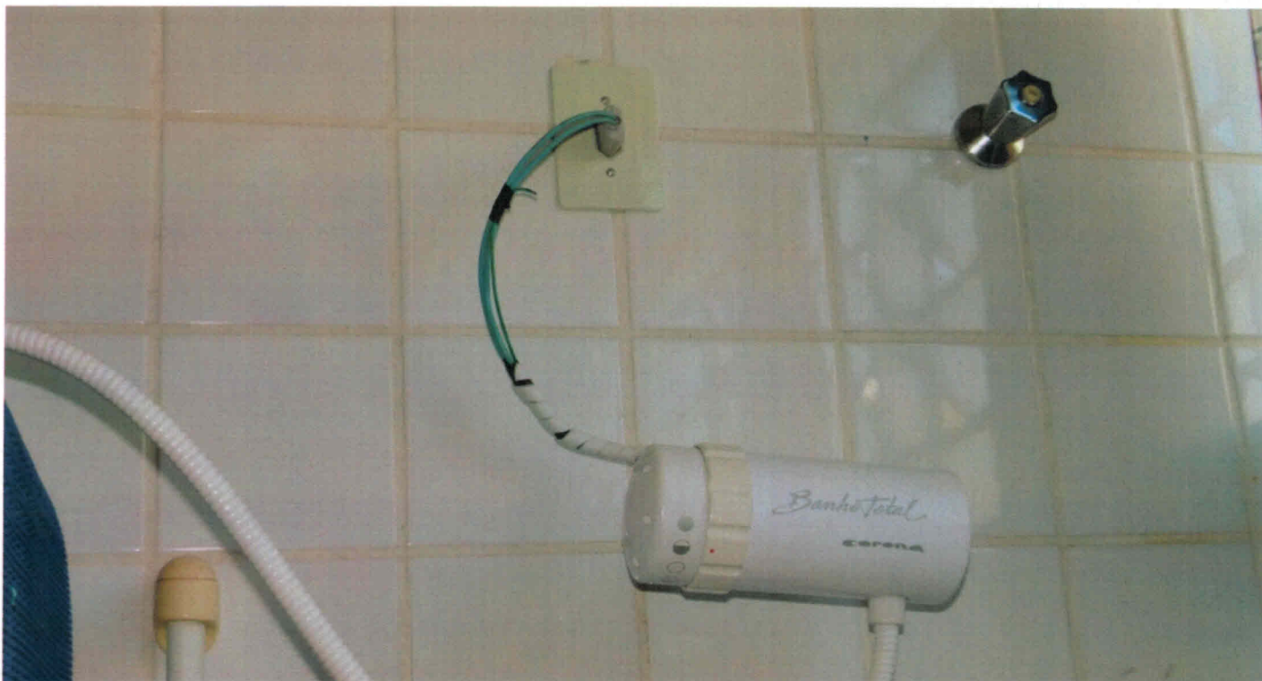
INSTALAÇÃO ELÉTRICA PRECÁRIA
