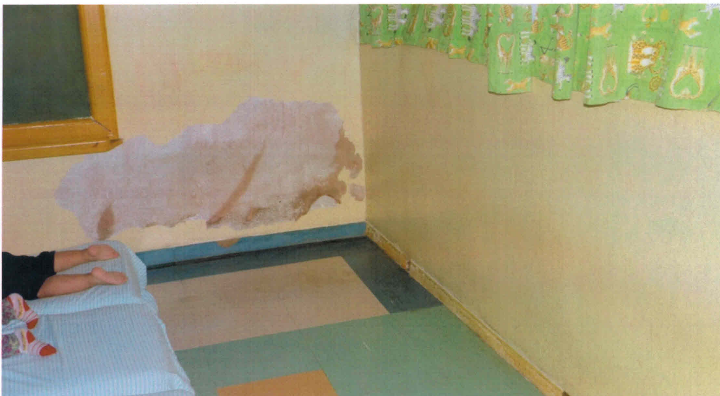
ESTUFAMENTO DA PINTURA - INFILTRAÇÃO
