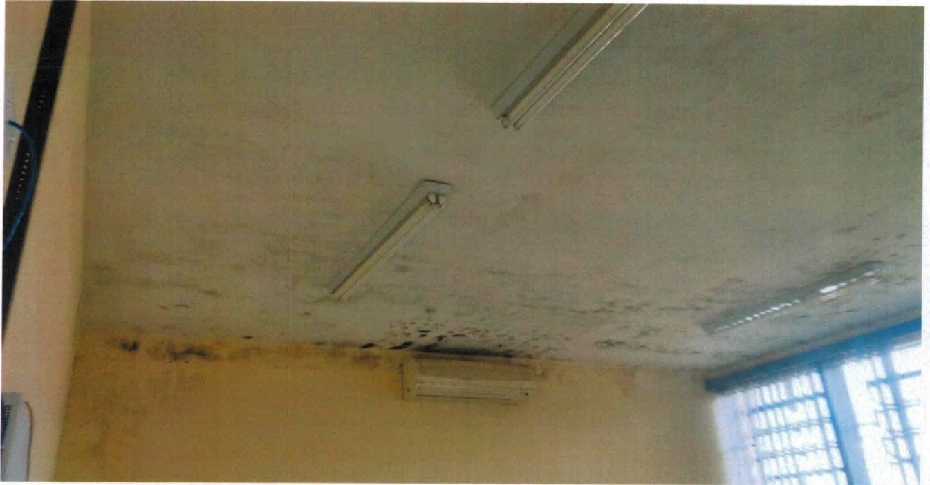
INFILTRAÇÃO SALA DE INFORMÁTICA
